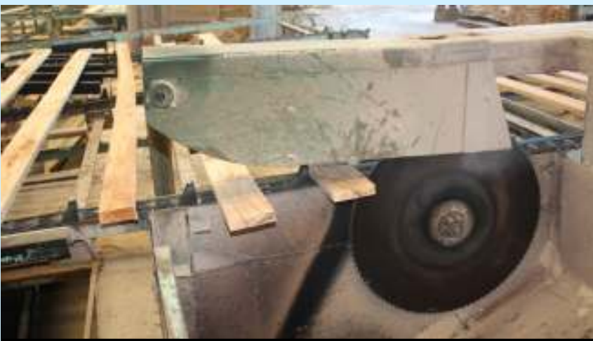
Arriba: Mesa de desplazamiento con correas de transmisión, un trabajador recibe y acomoda la tabla para el despuntado. Abajo: Sierra circular de despuntado con protección.
